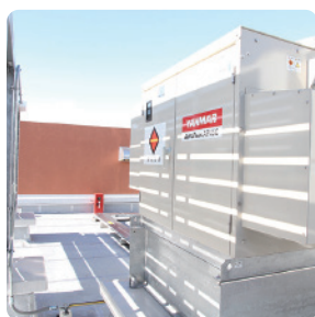
非常用発電機
